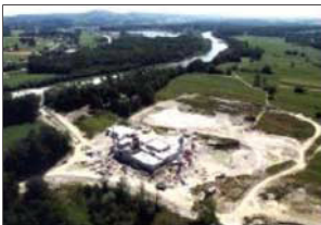
Abb. 3: Die Reinigungsanlage in Dogo•se – Aquasystem
