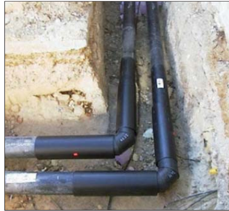
Abb. 12: Fernwärmeleitungen (Quelle: eigene Darstellung)
